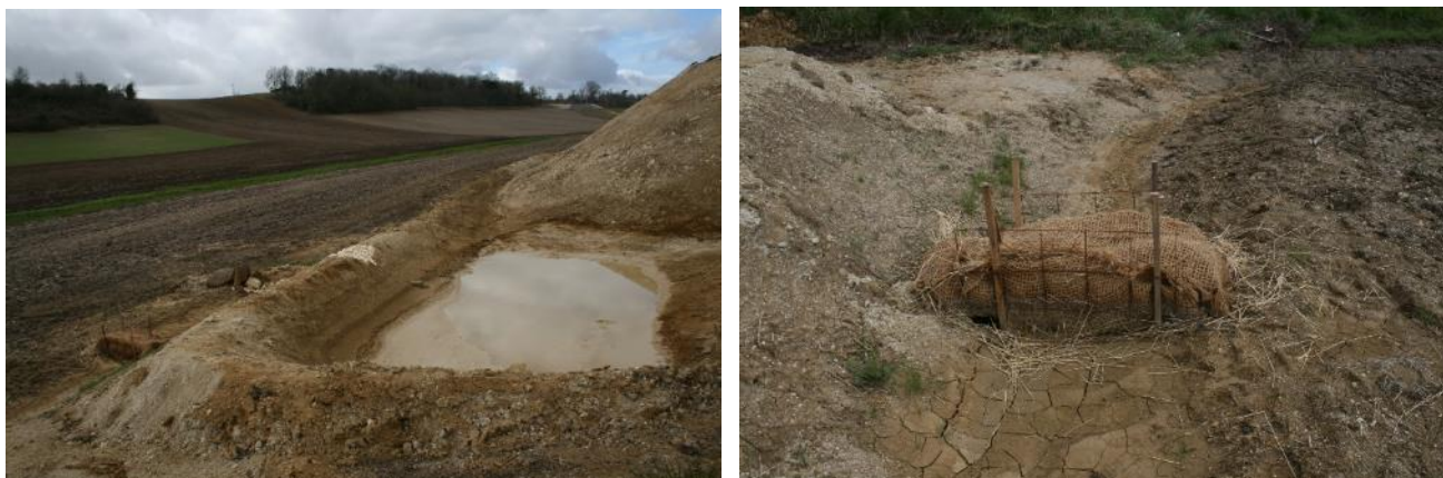
Figure 11 : Bassin de décantation étanche temporaire des eaux de ruissellement en phase de chantier avec filtre à paille en sortie
